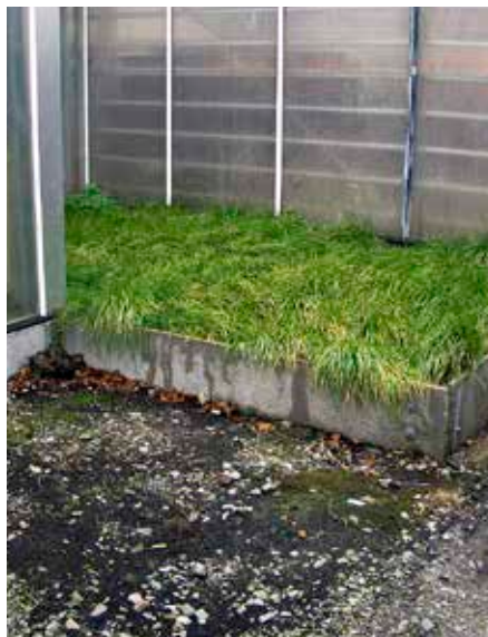
Invändig påfyllningsplats med uppsamling till utvändigt biobädd.
